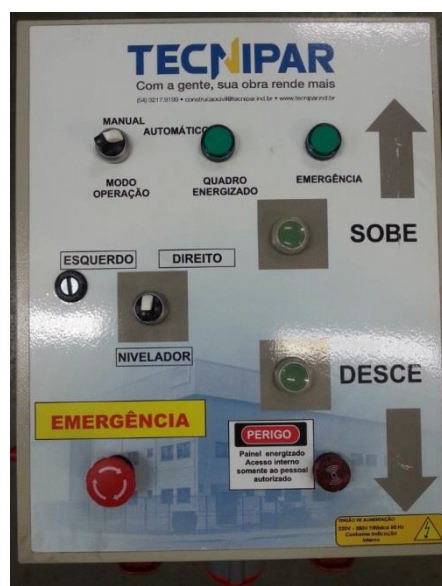
Quadro de Comando (23)
